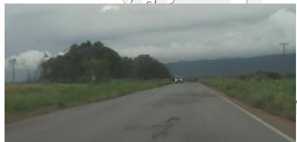
Figura 7: Trecho com pavimento irregular (carente de revitalização), com ausência de sinalização horizontal, vertical e acostamento
