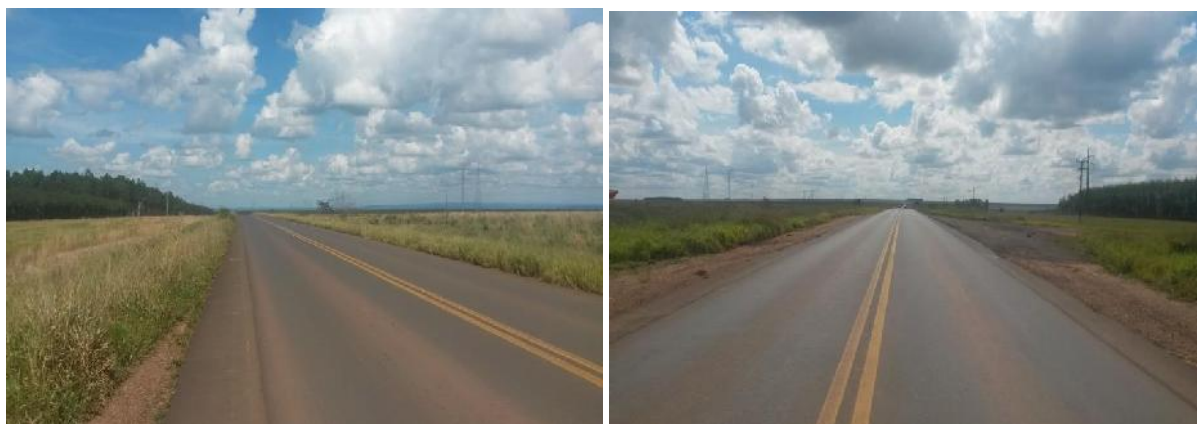
Foto 143 e 144: Visão ampla da rodovia que demonstra ausência sinalização vertical.
