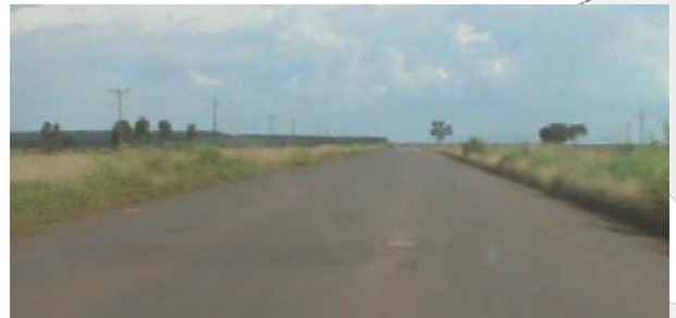
Figura 5: Trecho com pavimento regular, sinalização horizontal e vertical ausentes
