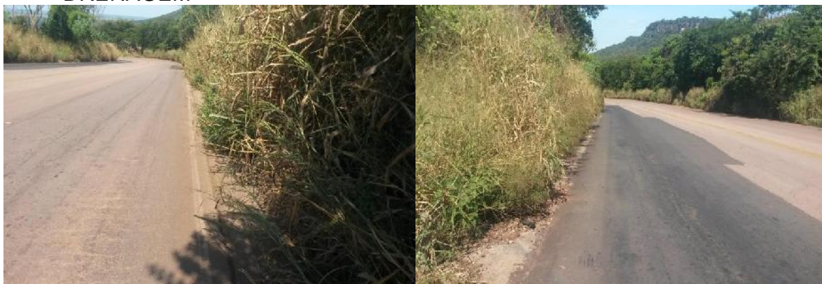
Foto 131 e 132: Km 30,1 a Km 29,60
